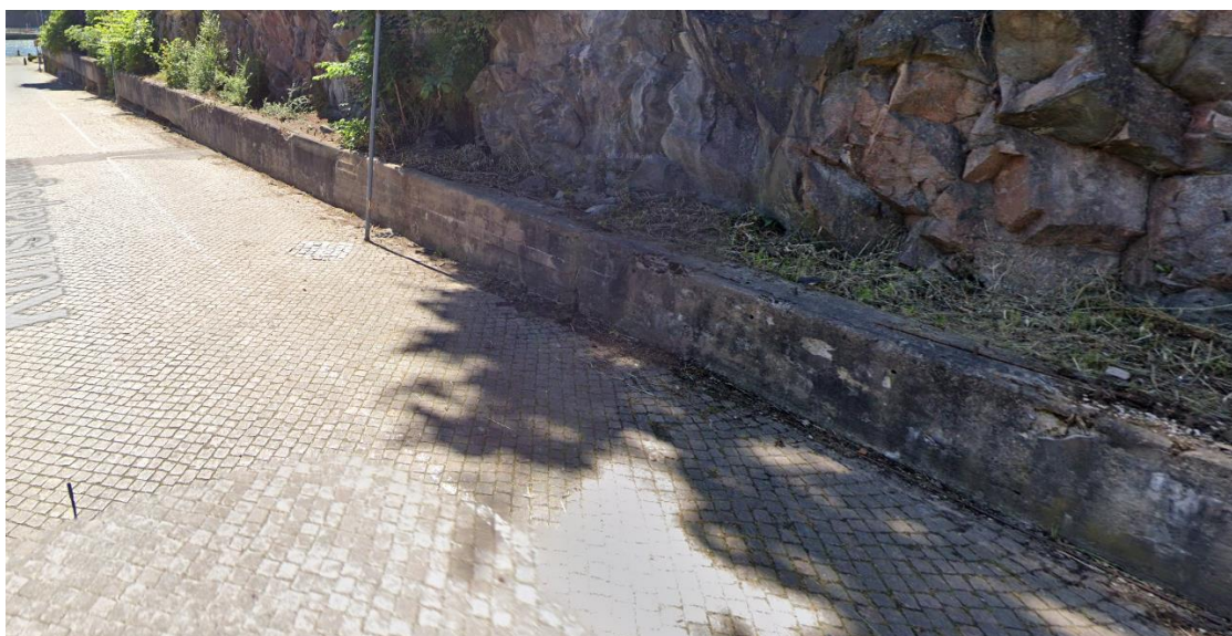
Figur 29. Bild på befintlig betongkonstruktion mellan bergvägg och befintlig väg. (Bildkälla Google maps 2025)
